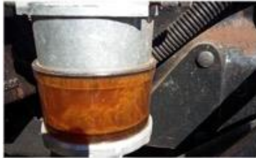
Figura 11. Filtro separador saturado com água e sedimentos.
